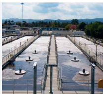
Plantas de Tratamiento de Agua
