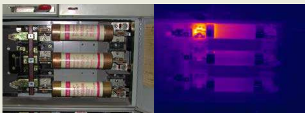
Desconexión del fusible
